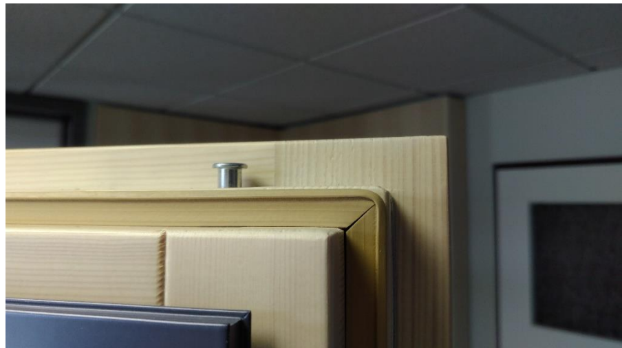
Abbildung 1: Korrekt sitzender Dichtungsgummi in einwandfreiem Zustand
